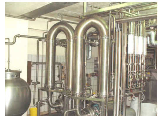
Installation de microfiltration de laiterie de Villefranche sur Saône
